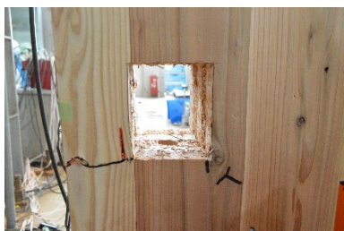
H ボルト穴・裏(試験後)
