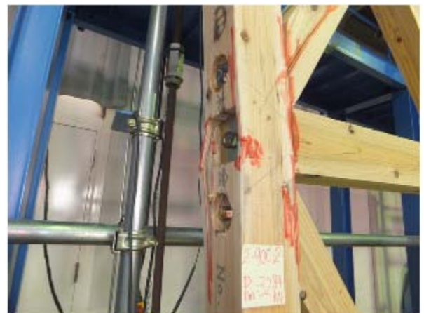
写真 14. 4-12 2-90C-2 上段圧縮筋かい端部の割れ、柱の割れ
