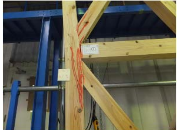
写真 14. 4-16 2-90C-3 上段圧縮筋かい端部の割れ、柱の割れ
