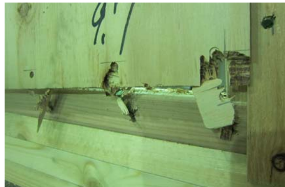
写真 2.4.4 隅角部の面材の縁切れ
