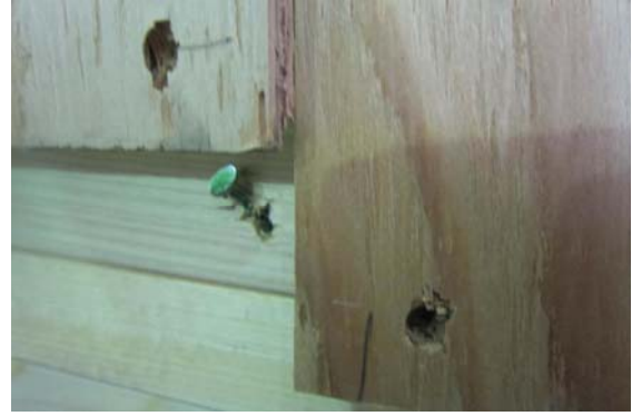
写真 4.2.6 くぎ頭の面材貫通
