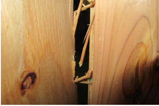
写真 2.4.5 面材の縁切れ(中間部)
