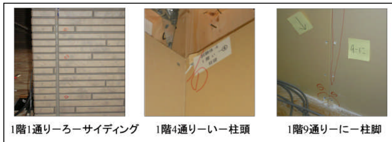
図 5.3.1-5 112.5%加振後の損傷状況 (代表例)
