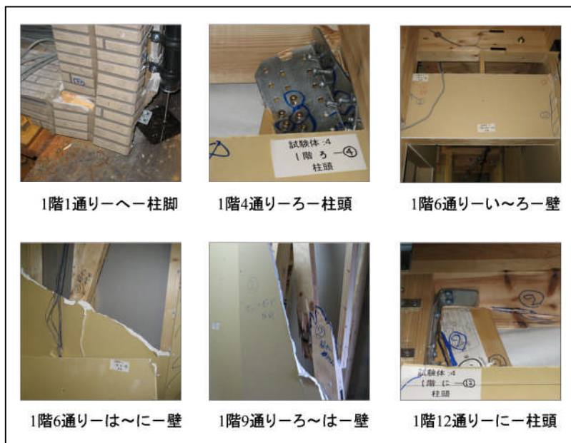
図 5.3.1-6 150%加振後の損傷状況 (代表例)
