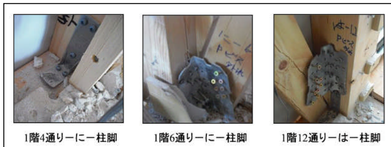
図 5.3.1-7 150%加振・内外装材除去後の損傷状況 (代表例)
