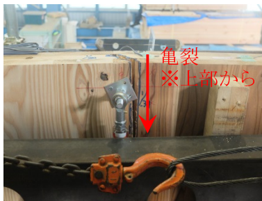
D 入隅部から亀裂 (1/30rad 引)
