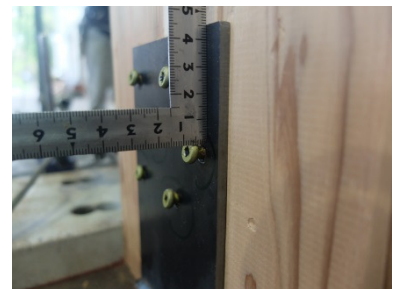
E 入隅部から亀裂 (1/30rad 引)
