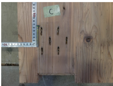
G 引張金物ビスのずれ跡 (解体後)
