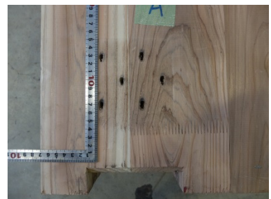
H 引張金物ビスのずれ跡 (解体後)
