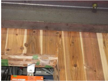
(1) 開口部右上亀裂(-1/50 押)
