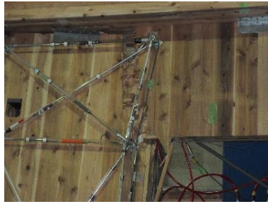
開口部左上破断(引き切り)
