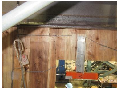
裏側開口部左上亀裂(-1/100 押)
