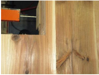
開口部右下亀裂(1/75 引)
