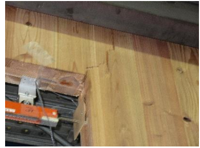
開口部(右上)亀裂(-1/50 押)
