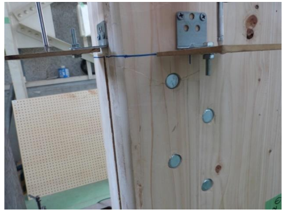
ドリフトピン最上部 圧縮破壊
