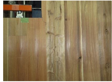
開口部(右下)から亀裂(-1/50 押)
