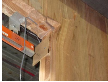
開口部(閉じる側)押しつぶれる (引き切り)
