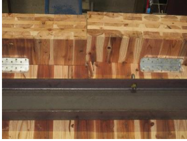
右側床パネル浮き上がり(1/20 引)
