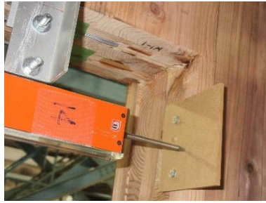
開口部左上亀裂(1/50 引)
