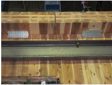
(4) 開口部右上亀裂(-1/30 押)
