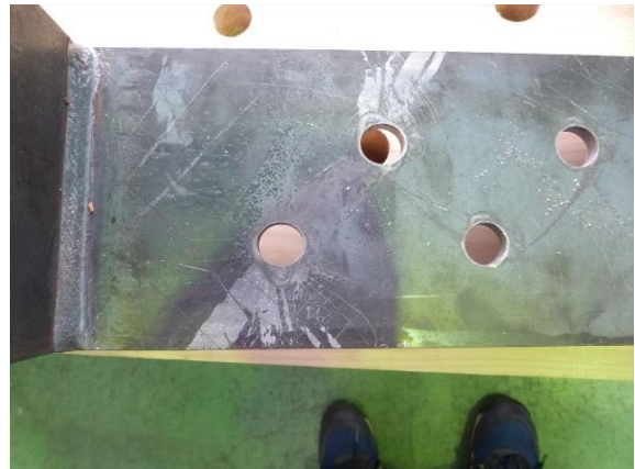
鋼板孔部 支圧変形
