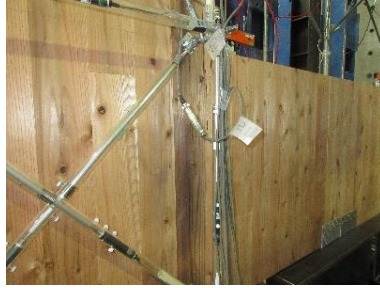
開口部(左下)から亀裂(1/50 引)
