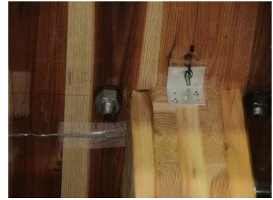
壁パネル左上めり込み(1/20 引)
