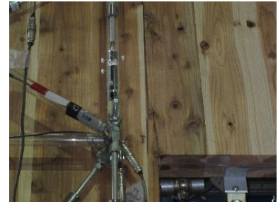
開口部左上亀裂(1/50 引)
