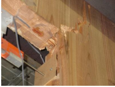
開口部(右上)亀裂(-1/30 押)
