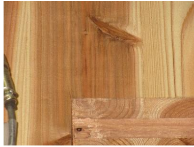
開口部左上亀裂(1/75 引)
