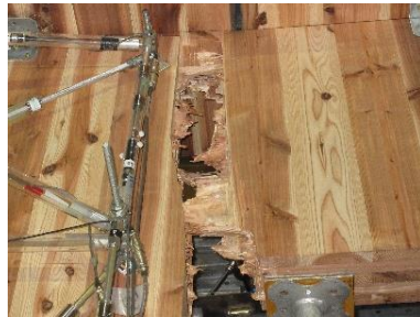
開口部左上破断(引き切り)
